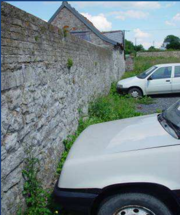
Pied de mur Parking Eglise
