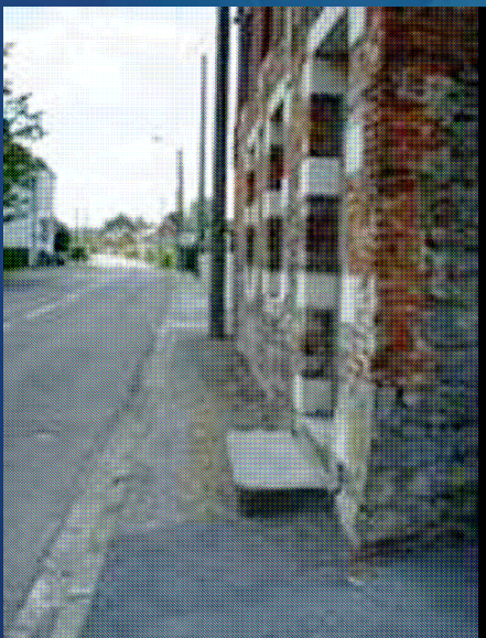
Pied de mur Route de Sars
